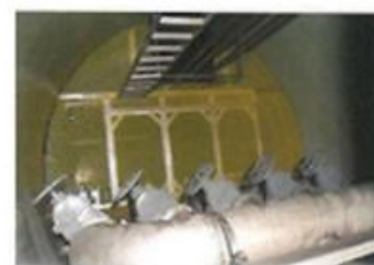
内部安装采用多元化管路集成
